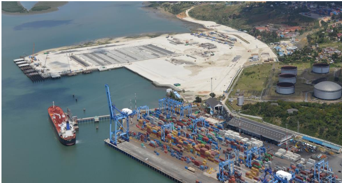
Figure 0-5: Vue aérienne avec la phase 1 du terminal à conteneurs 2 de Mombasa en cours de construction
